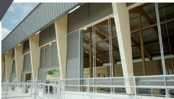
Ventilation automatique et accès Natürliche Lüftung und Tore
